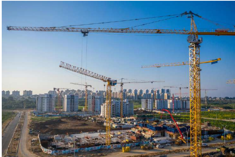
בנייה באשקלון. "יש פרויקטים שבהם הקבלנים מימנו עיכובים בעשרות מיליוני שקלים" (צילום: תומר שונם הלוי)
