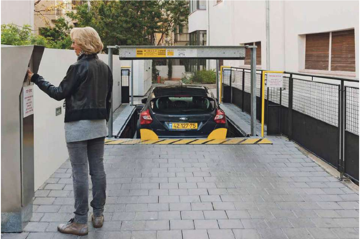
מתקן חניה אוטומטי, במתחם התכנון טוענים שיש בעיה בטיחותית (צילום: פרומט מתקני חניה)
