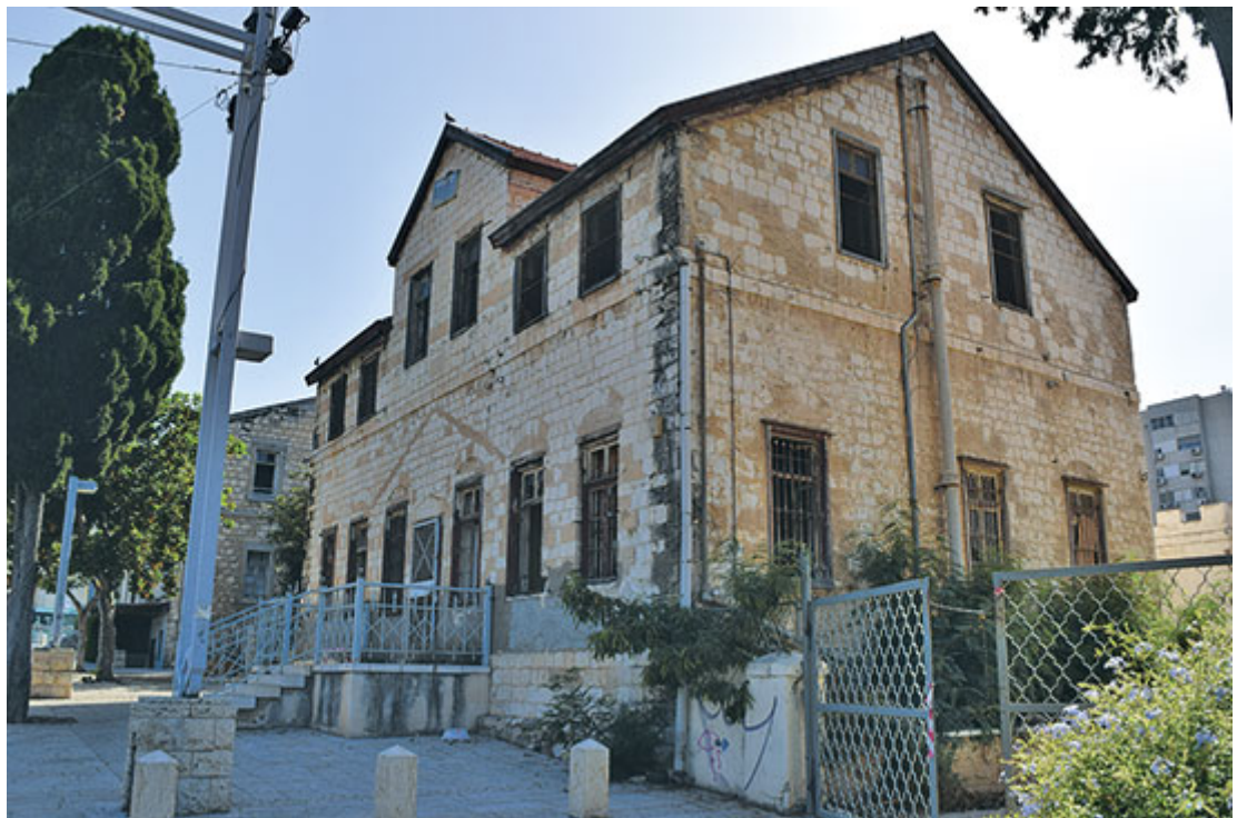
הלבניות: "ציפוי הבטון מתקלף וזיון הברזל גלוי ומחליד בחלקו"
